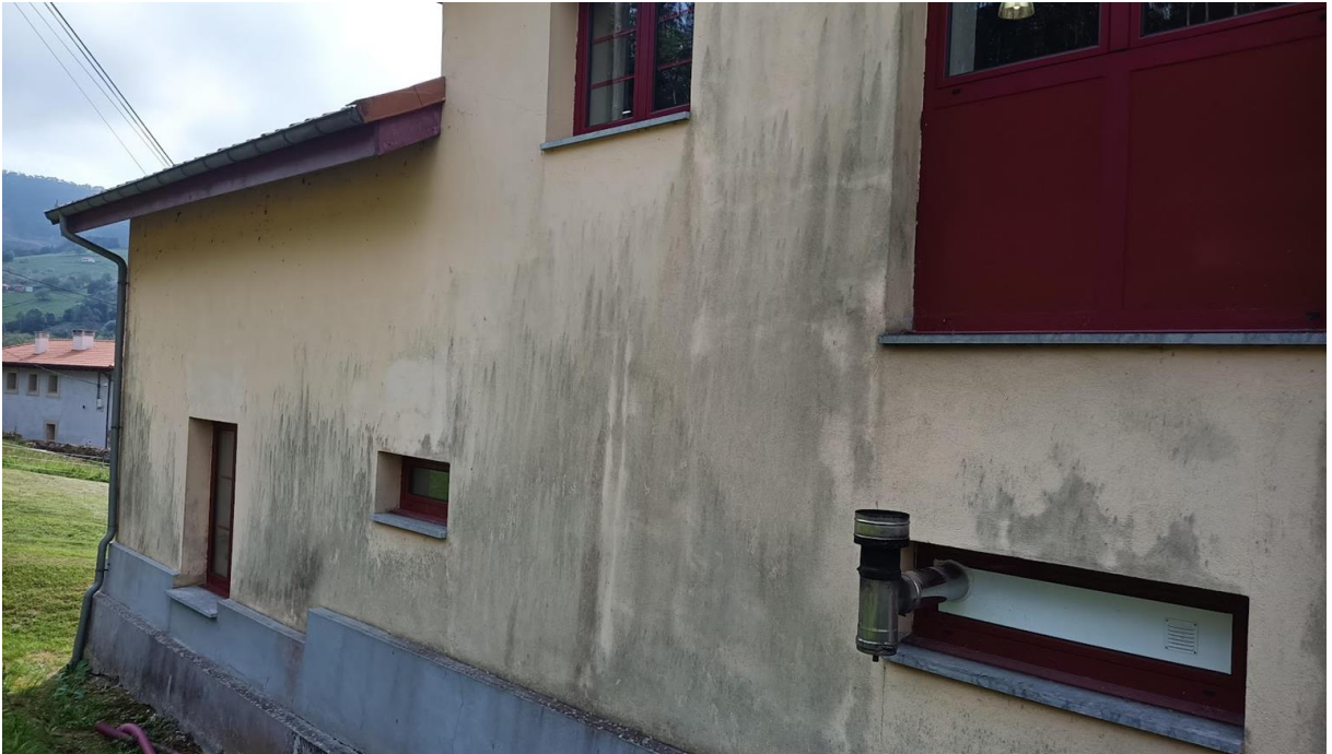
Fachada posterior del edificio por dónde deberán discurrir la/las canalizaciones hacia los cuadros interiores.
