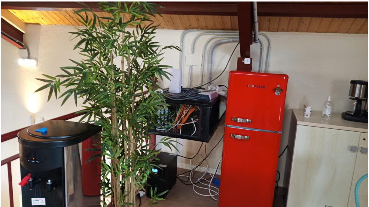
Armario de comunicaciones del piso superior. Situado sobre pared que da al exterior. El cuadro podría situarse bajo el armario.
