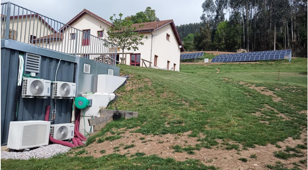
Contenedores donde se instalará el SAI. Se pueden observar las canalizaciones existentes y por donde discurren hacia el edificio superior.
